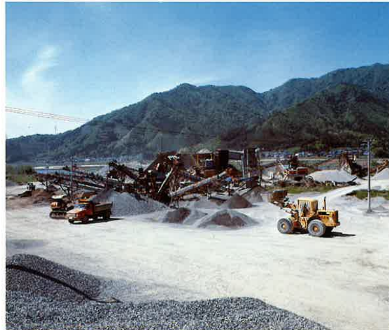
本社工場（プラント性能） 川砂利用 130 t/r - 1 基 山砕石用 100 t/r - 1 基
